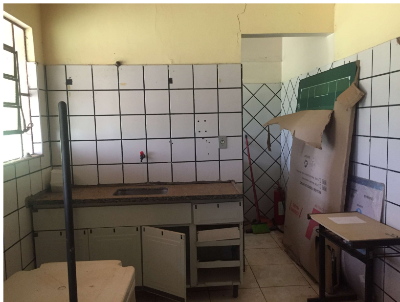
Foto 26 – Gabinete e pia da cozinha da lanchonete
