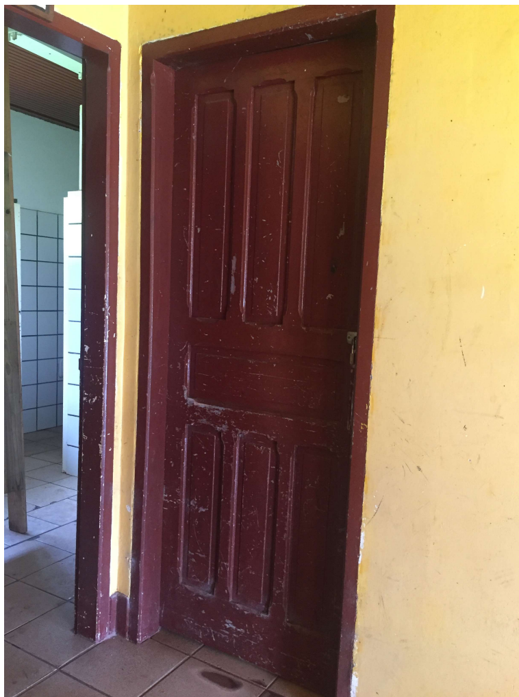
Foto 11 – Porta da sala utilizada como depósito
