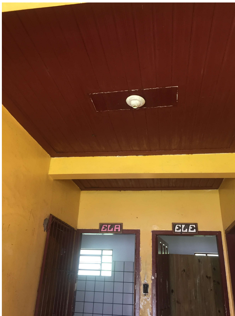
Foto 21 – Ponto de iluminação do corredor
