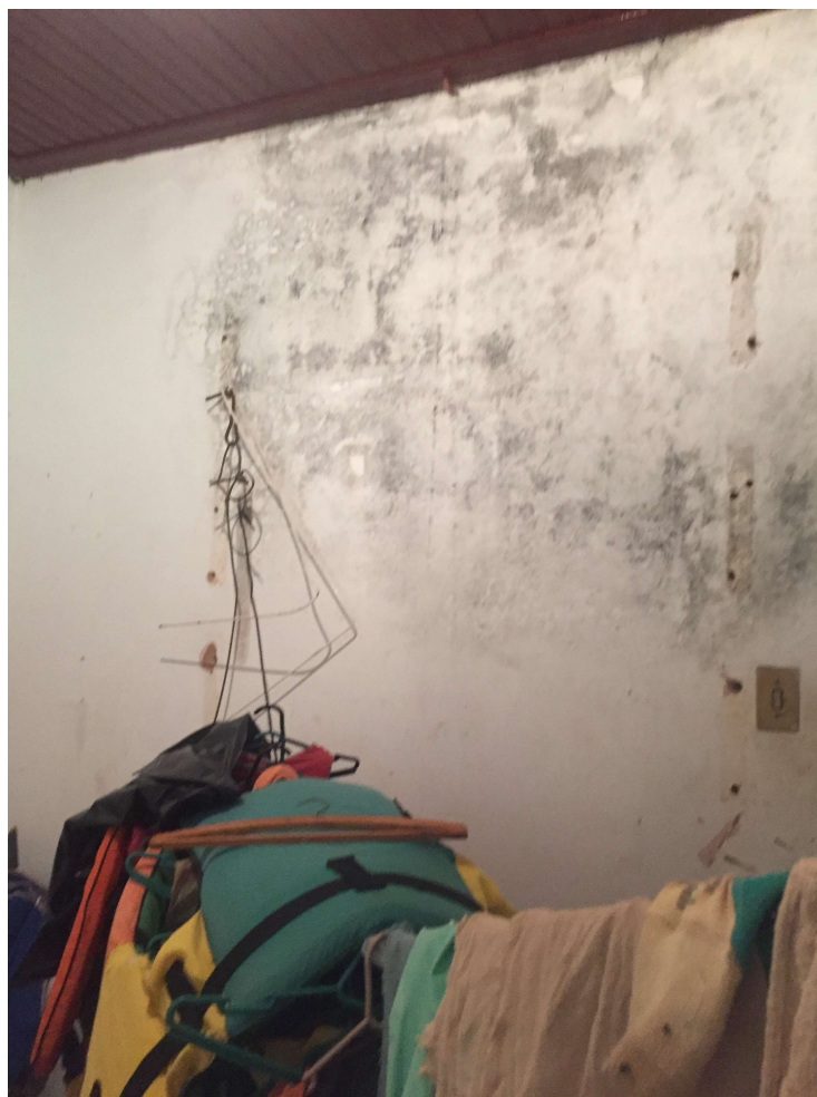
Foto 28 – Infiltração na parede da sala utilizada como depósito
