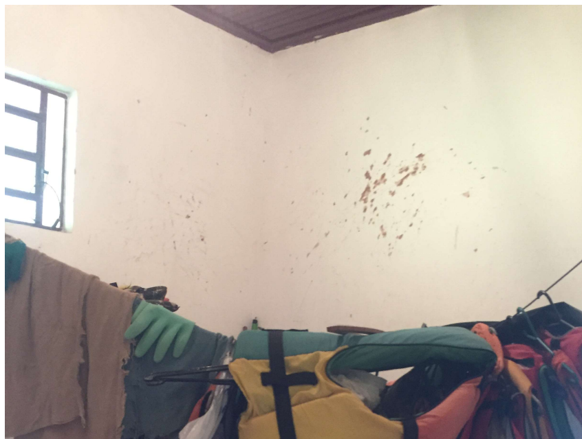
Foto 30 – Detalhe das paredes descascadas, da sala utilizada como depósito
