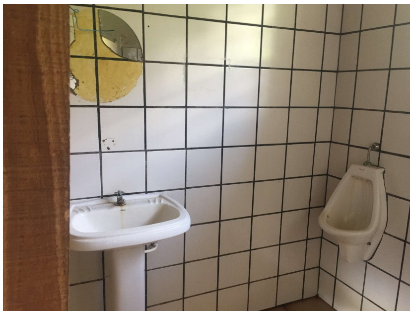
Foto 18 – Lavatório e espelho do banheiro masculino
