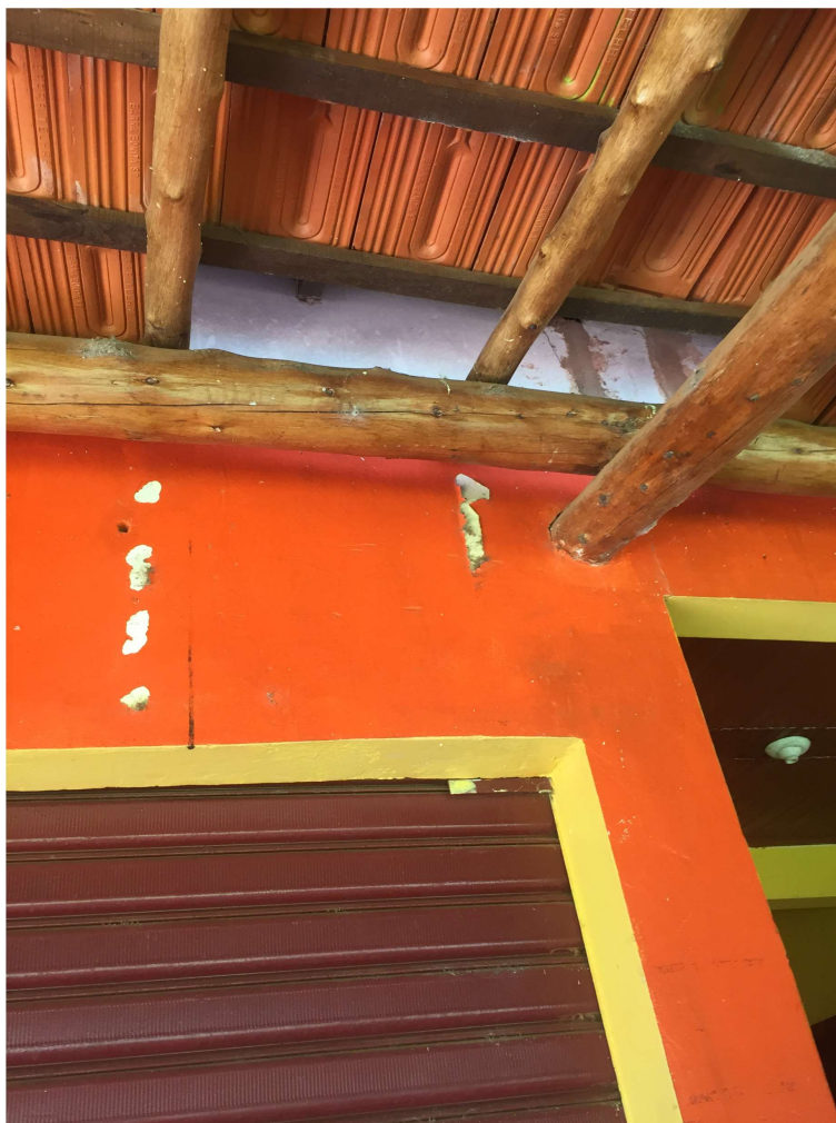
Foto 8 – Detalhe do telhado com falta de telhas
