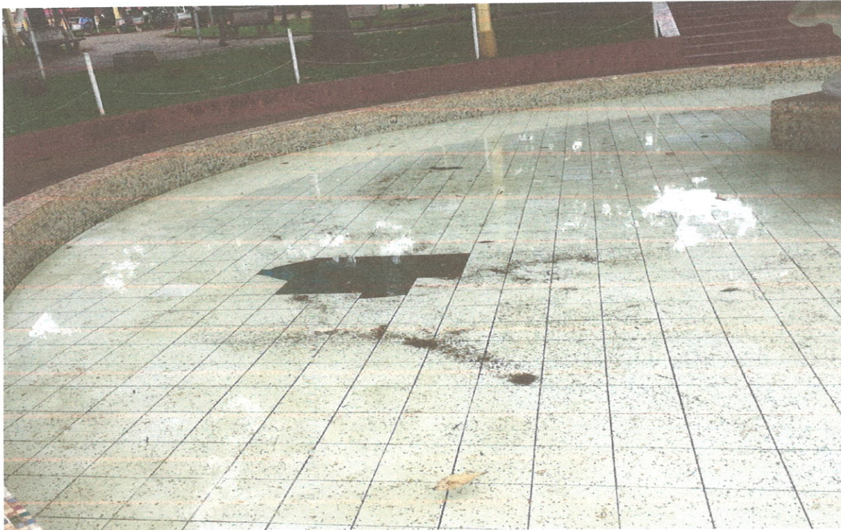
Recomposição com novo revestimento cerâmico do piso, semelhante ao original, pastilhas coloridas ce 2,5 x 2,5 cm, conforme detalhe abaixo.
