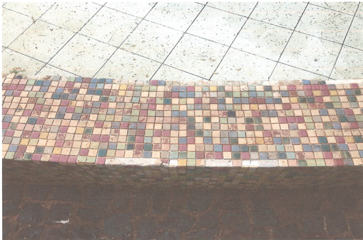
Reforma das instalações hidráulicas, com a restauração dos bicos de jatos, que estão entupidos, bem como das instalações elétricas, notadamente da iluminação colorida, que não está em funcionando.
