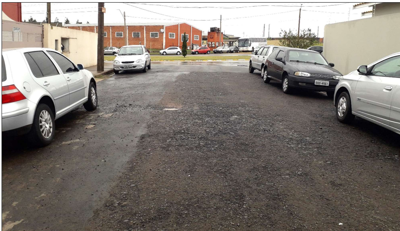
Foto 2. Situação atual da via na Rua Finlândia.
