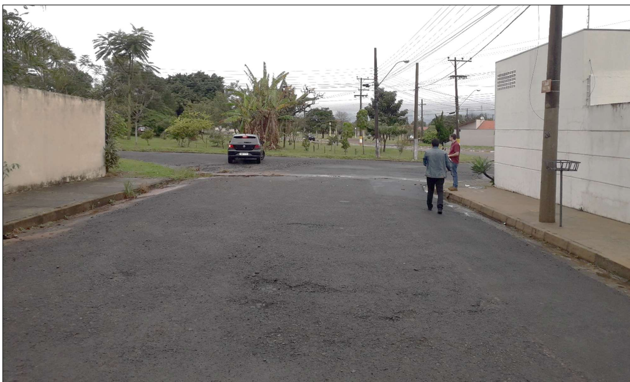
Foto 7. Situação atual da via na Rua Finlândia.
