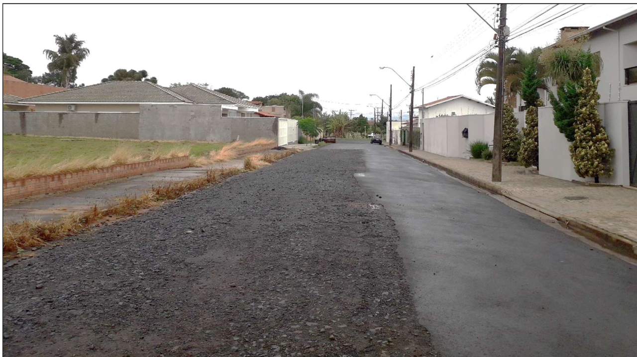
Foto 5. Situação atual da via na Rua Finlândia.
