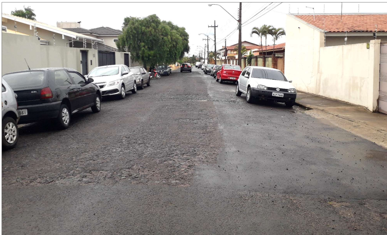
Foto 1. Situação atual da via na Rua Finlândia.
