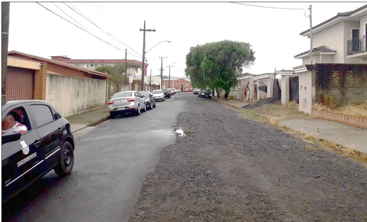
Foto 4. Situação atual da via na Rua Finlândia.
