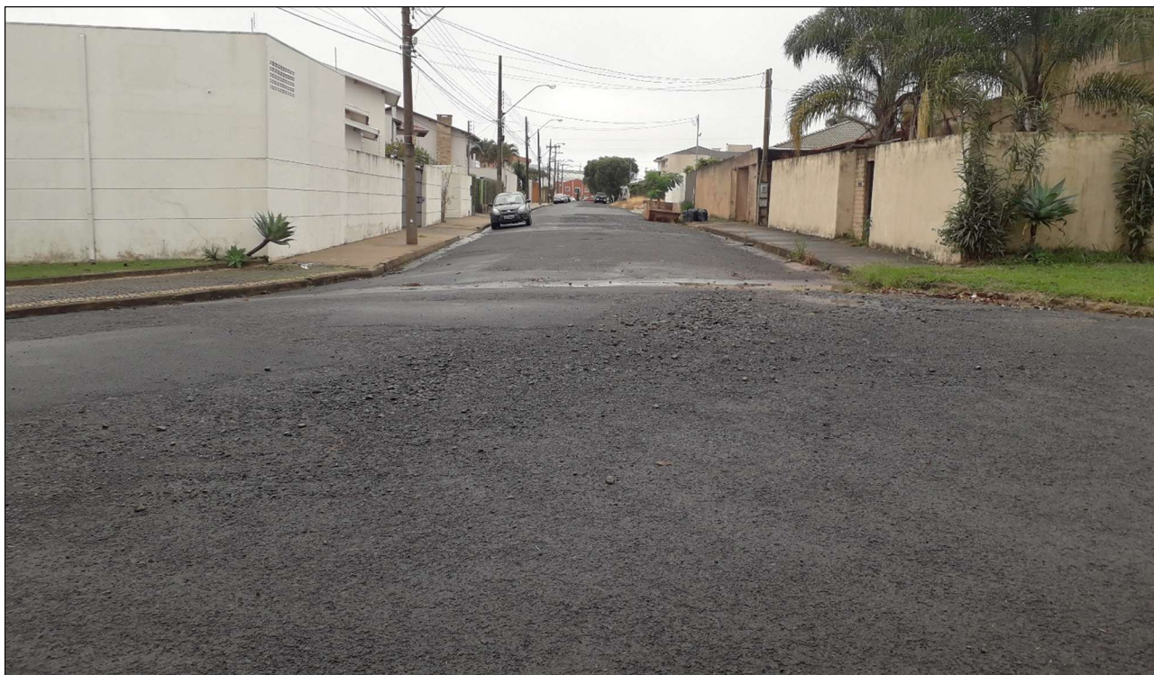
Foto 8. Situação atual da via na Rua Finlândia.
