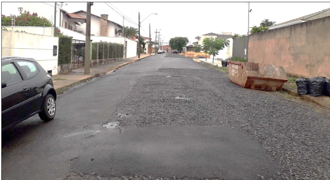
Foto 6. Situação atual da via na Rua Finlândia.
