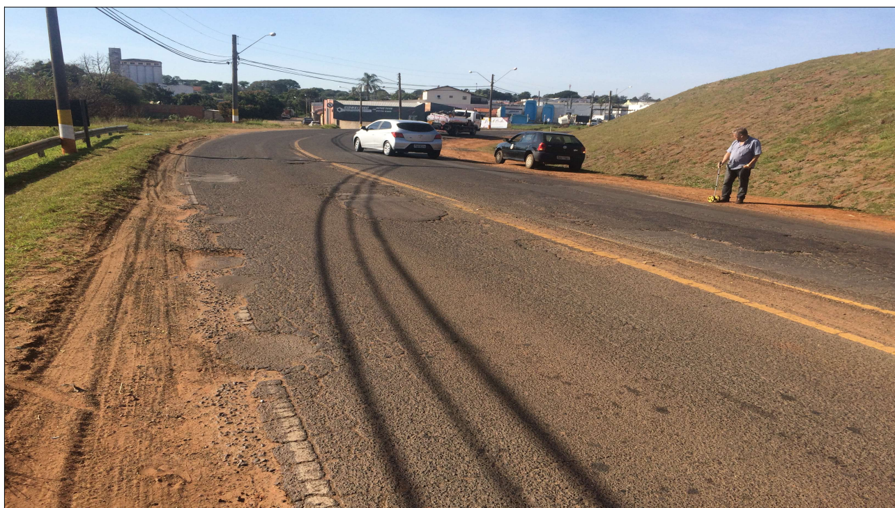
Foto 9. Situação atual da via na Av. Anápolis.
