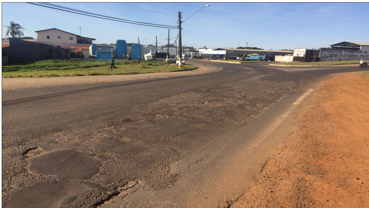
Foto 6. Situação atual da via na Av. Anápolis.
