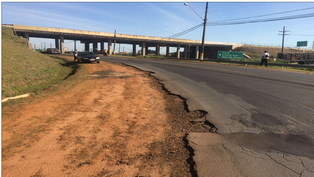
Foto 8. Situação atual da via na Av. Anápolis.
