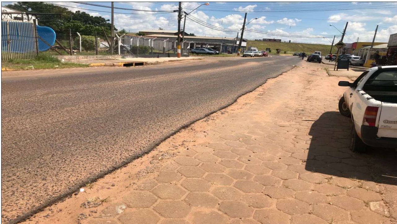
Foto 2. Situação atual da via na Av. Anápolis.
