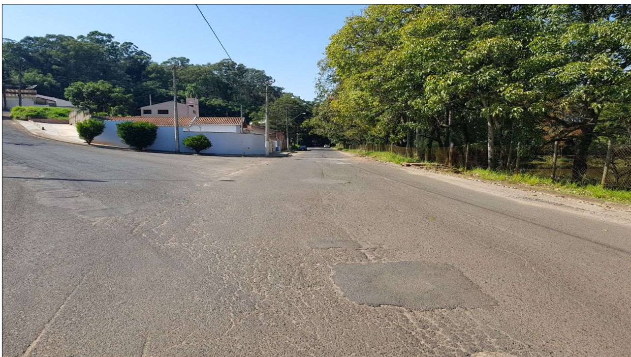
Foto 17. Situação atual da via na Rua Francisco Cruz com Rua dos Curiós.
