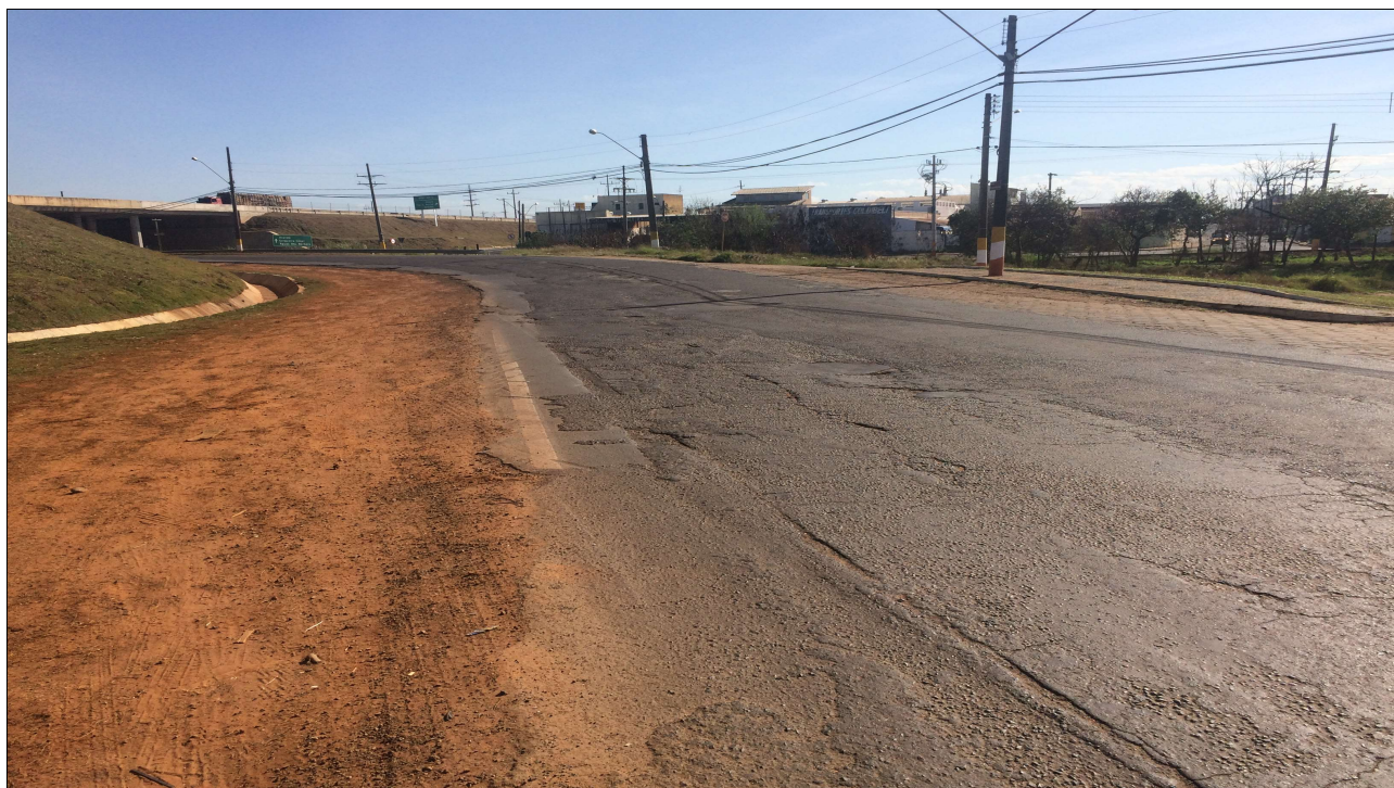
Foto 7. Situação atual da via na Av. Anápolis.
