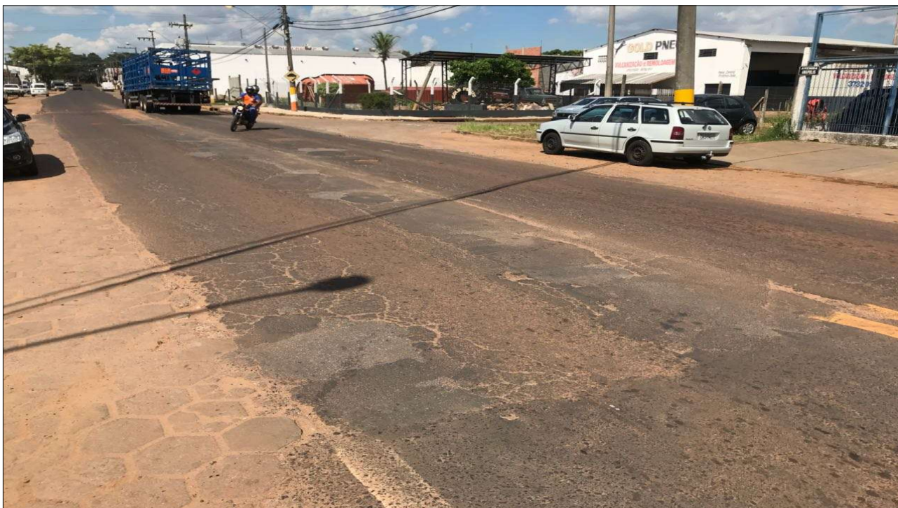
Foto 5. Situação atual da via na Av. Anápolis.
