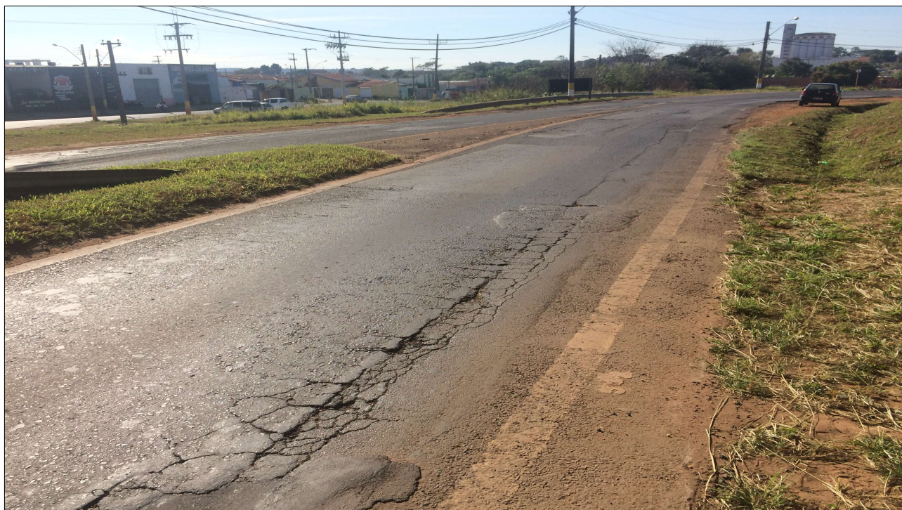
Foto 11. Situação atual da via na Av. Anápolis.
