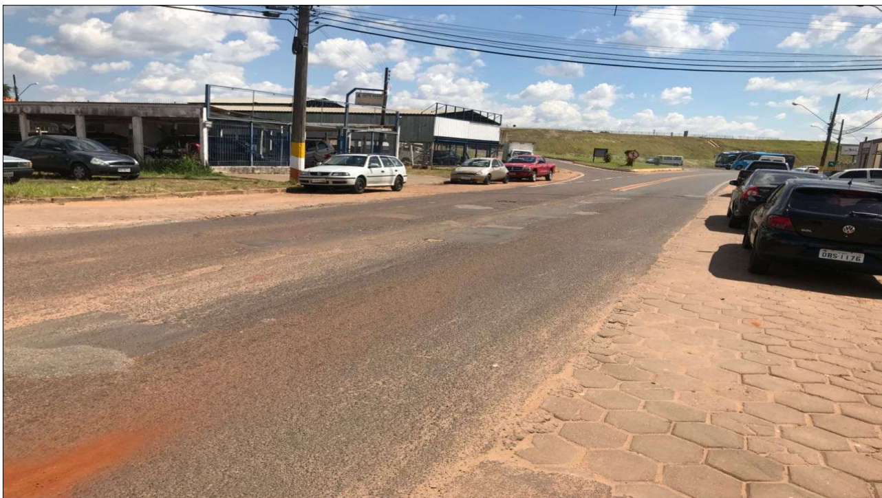
Foto 4. Situação atual da via na Av. Anápolis.
