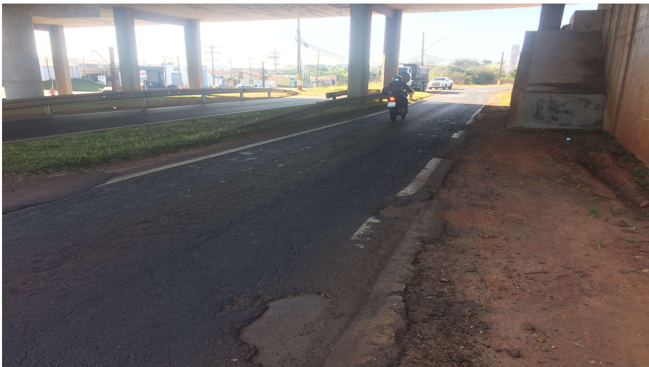
Foto 12. Situação atual da via na Av. Anápolis.
