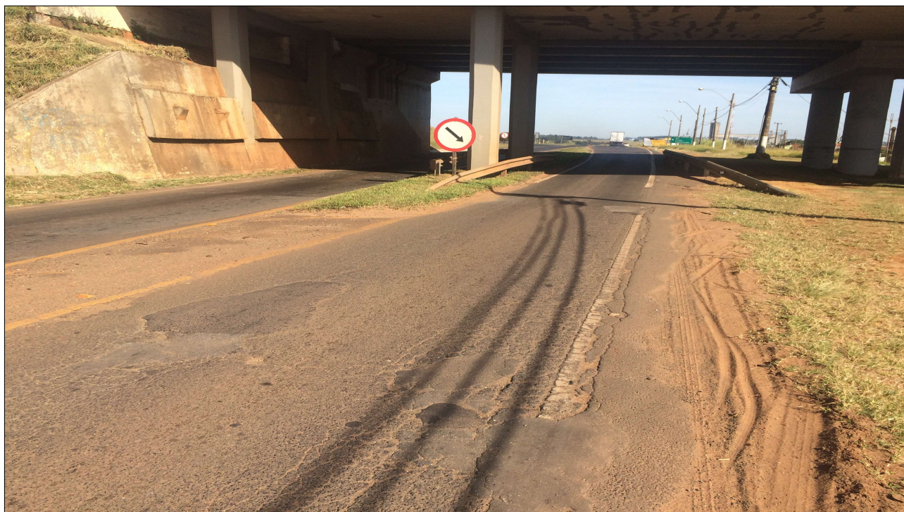
Foto 10. Situação atual da via na Av. Anápolis.
